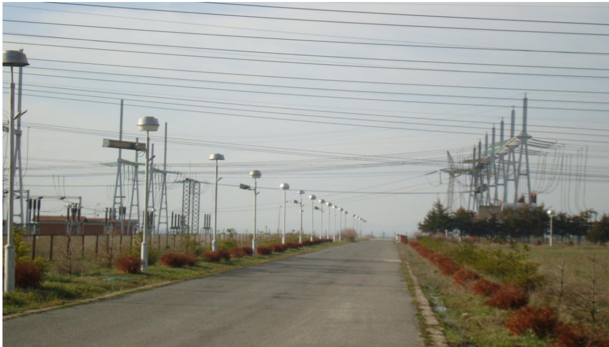
Pogled na trafo-stanicu Kosovo B
