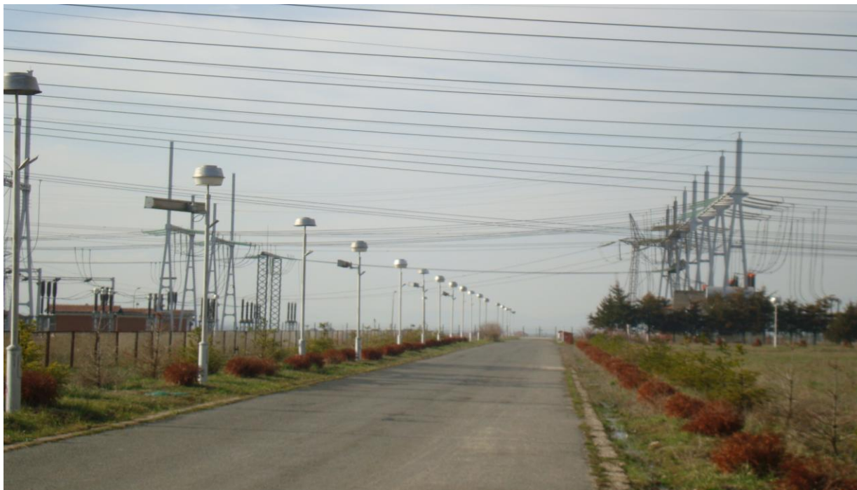
Pamje nga trafostacioni Kosova B
